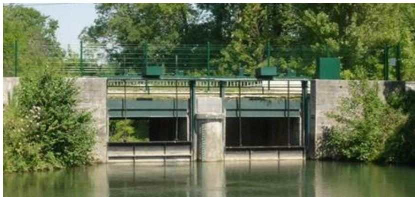
Ouvrage hydraulique de l'agglomération troyenne (Source : TCM)
