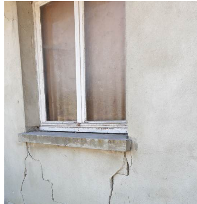
Fissure (Source : mairie d'Epagne)
